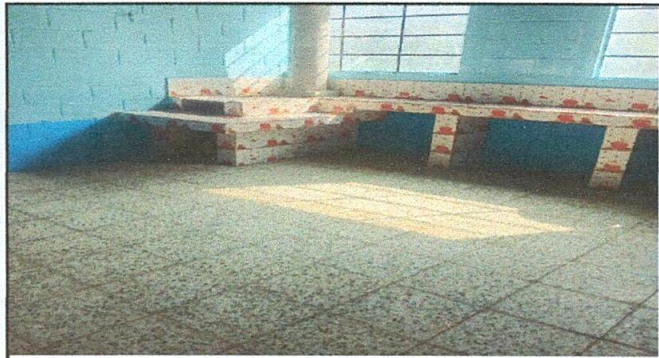
Foto 3: Piso agrietado (Después)
